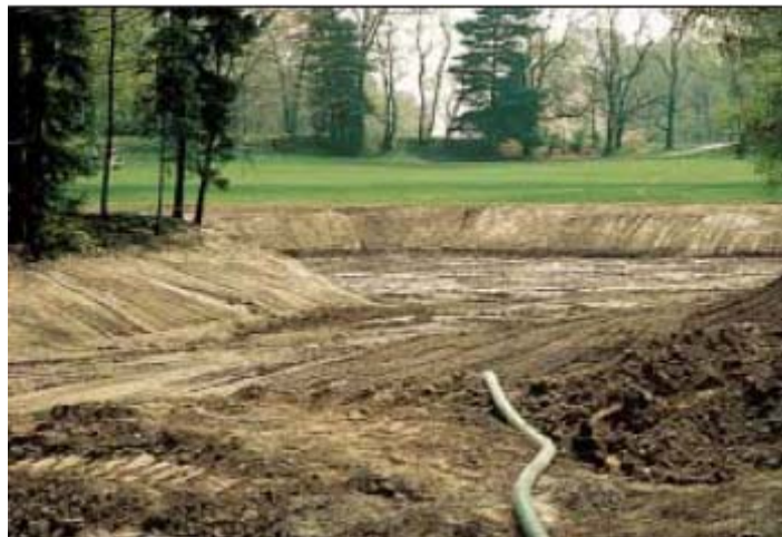
Figura 4.21-Reservatório de retenção no campo de golfe para reter águas pluviais
