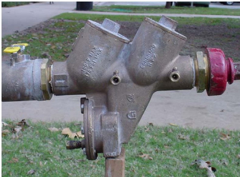
Figura 4.11- Valvula redutora de pressao e valvula retentora de fluxo usadas em irrigação.
