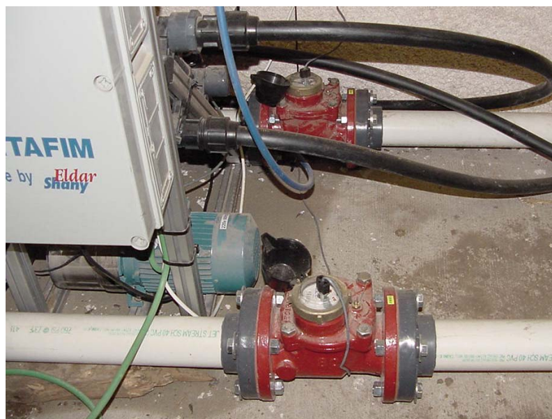
Figura 4.10- Medição da água para irrigação, observando-se um hidrometro Woltman.
