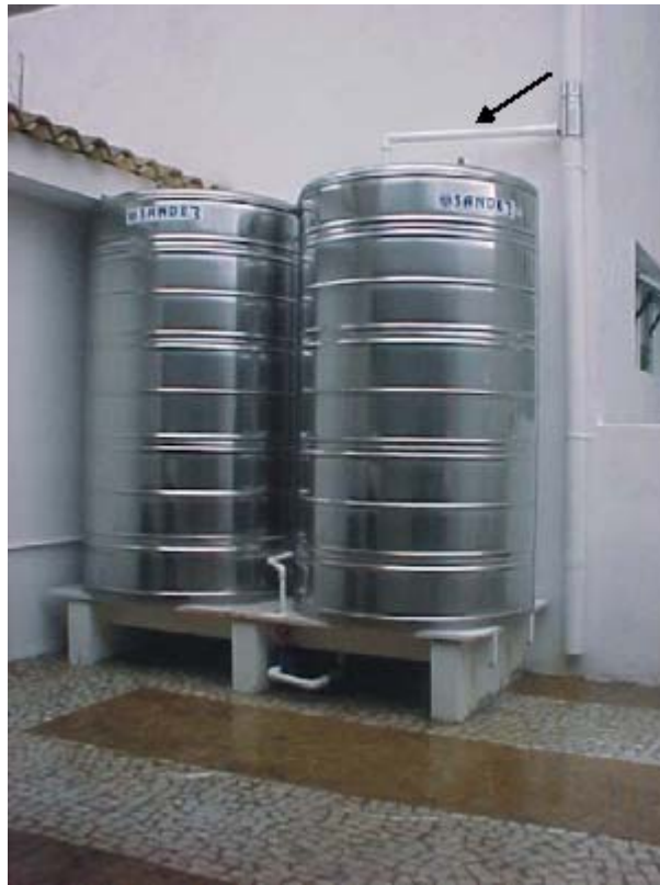
Figura 6.4- Reservatórios de aço inox apoiados
