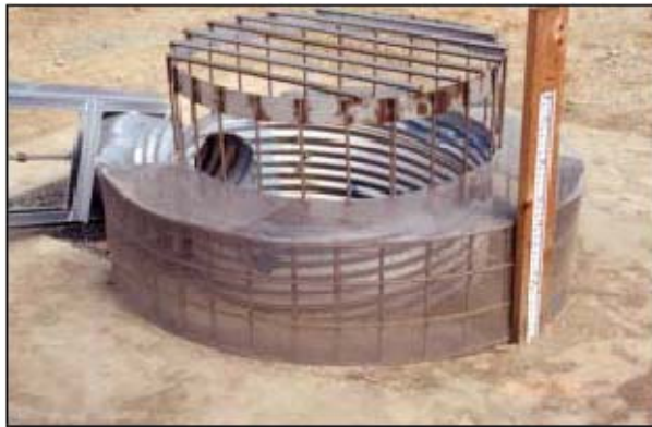
Figura 7.6- Orifício com grade de proteção contra entupimento
