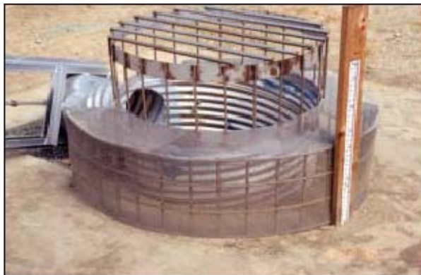
Figura 7.11- Orifício com grade de proteção contra entupimento
