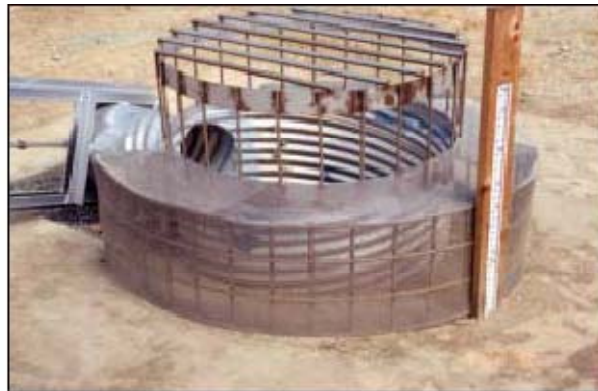
Figura 7.8- Orifício com grade de proteção contra entupimento
