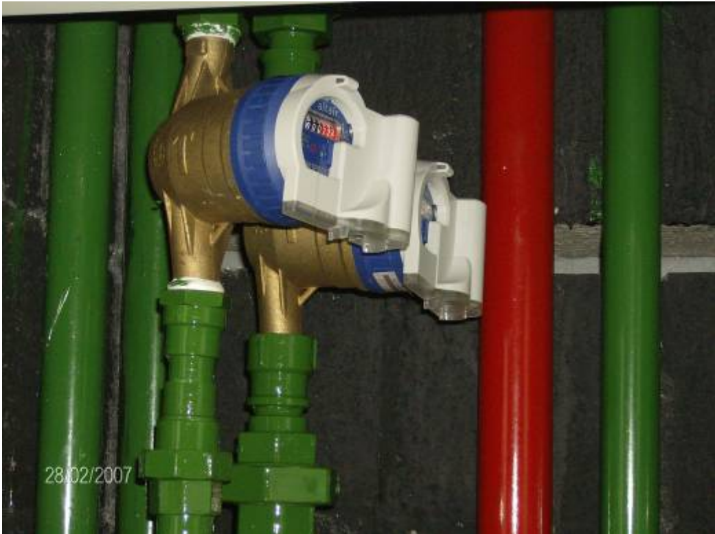
Figura 24.1- Instalação vertical no hall de serviço Fonte: Techem do Brasil Ltda
