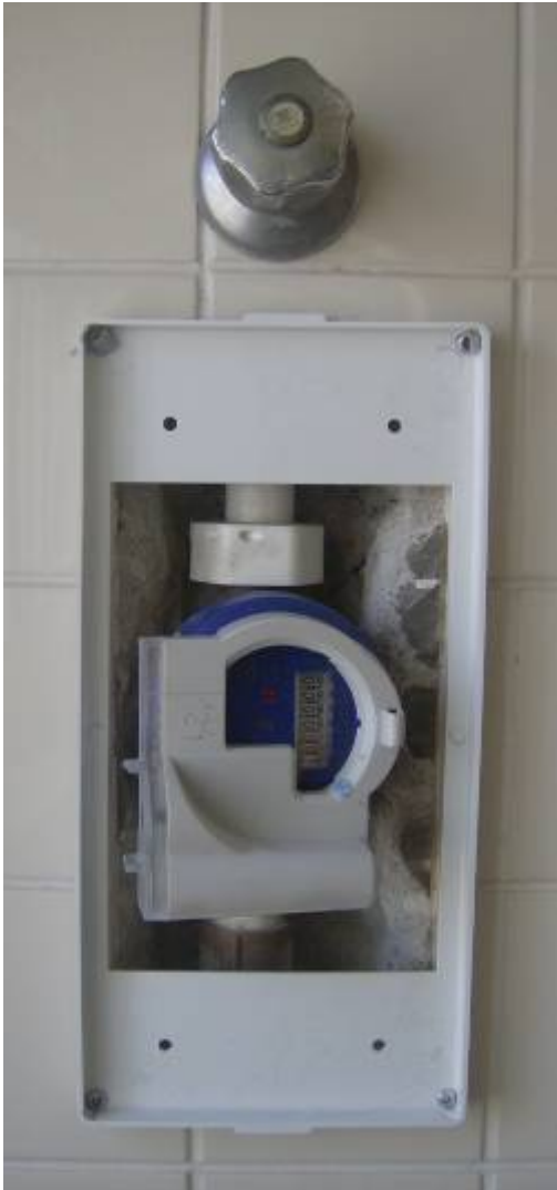
Figura 24.1- Instalação vertical não preparada e localizada na área de serviço Fonte: Techem do Brasil Ltda
