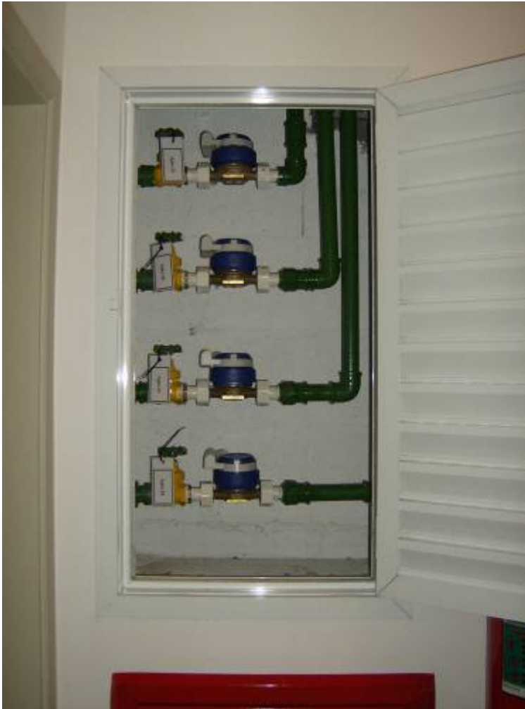
Figura 24.1- Instalação horizontal no hall de serviço Fonte: Techem do Brasil Ltda
