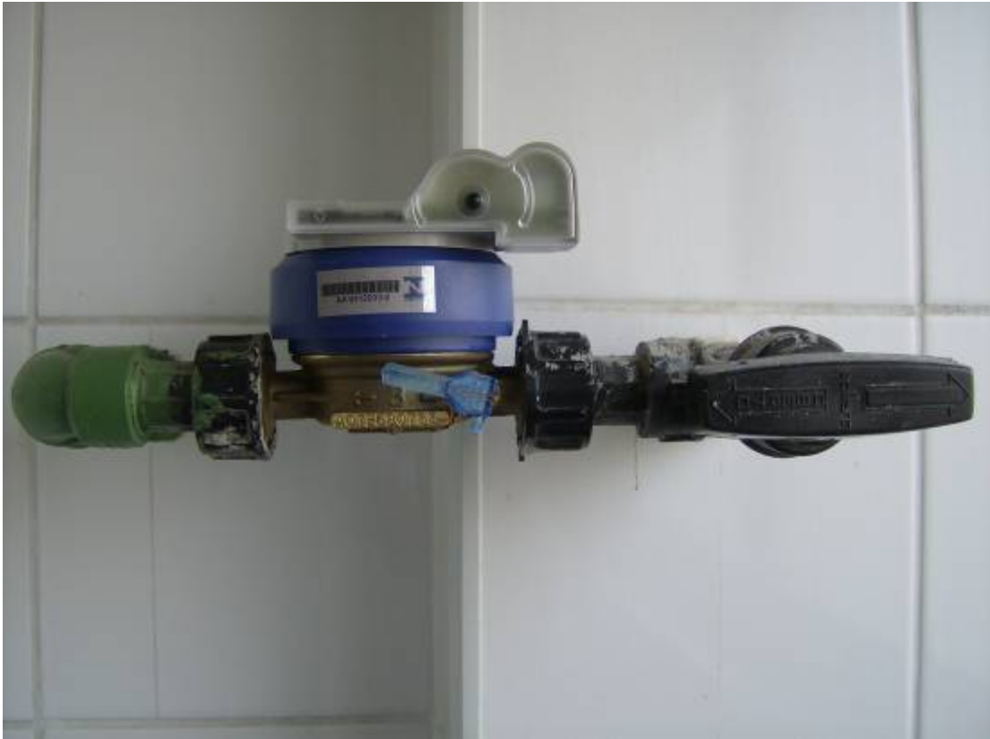
Figura 22.1- Instalação horizontal em área de serviço Fonte: Techem do Brasil Ltda
